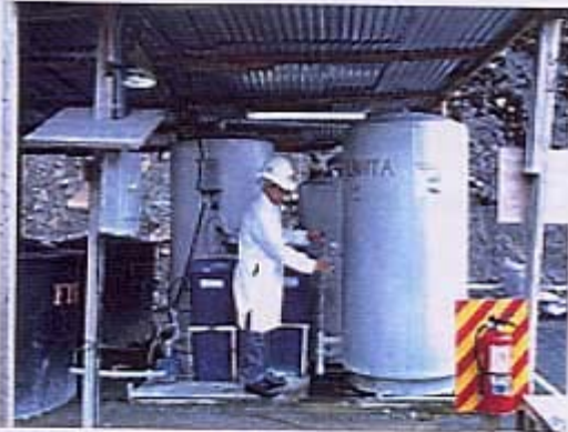
Traitement des eaux
